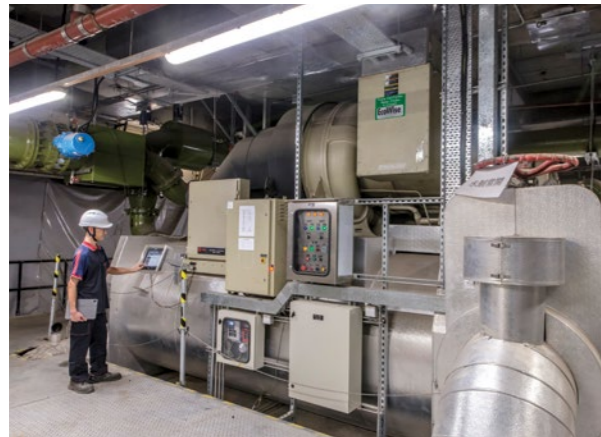
屯門醫院的製冷機組設備使用低全球變暖潛能值的雪種，相比傳統雪種，新型雪種大大減低了對全球暖化的影響。
