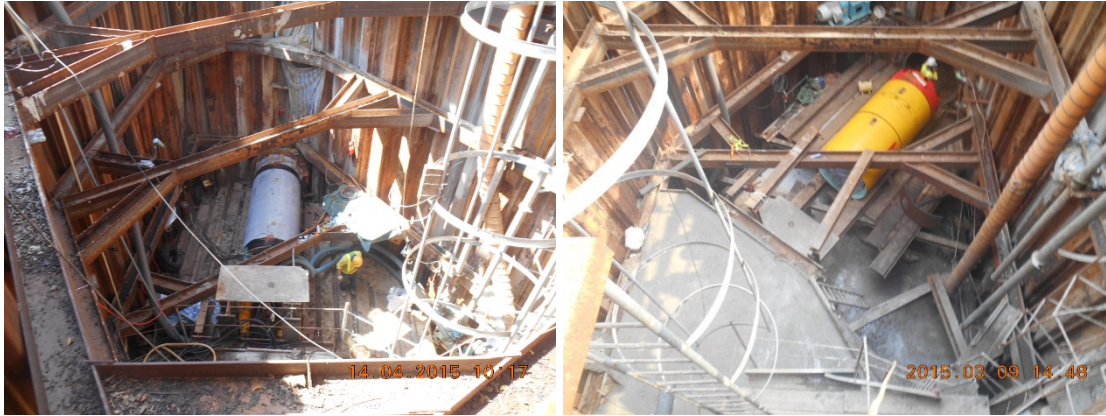
图 6. 在复杂地区用顶管技术及隧道掘进机敷设DCS系统管道
