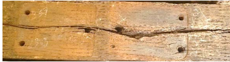
圖 19：腐爛的木製軌枕
