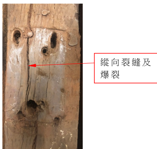
圖25：腐爛的木製軌枕
