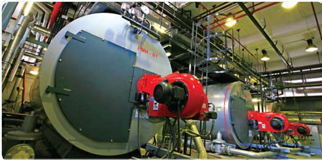
我們支援本港公立醫院的機電設備（圖為大型鍋爐），確保醫院向公眾提供無間斷醫療服務。
