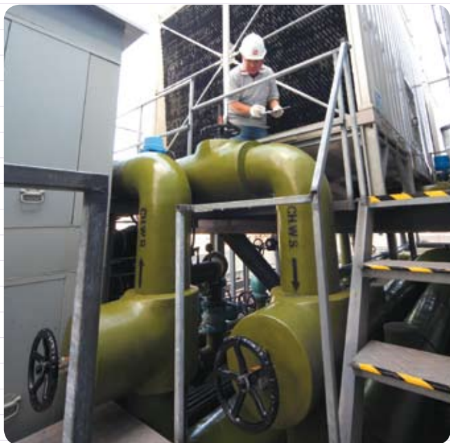
機電工程營運基金為政府大樓維修保養空調系統，令使用大樓的人士舒適。
