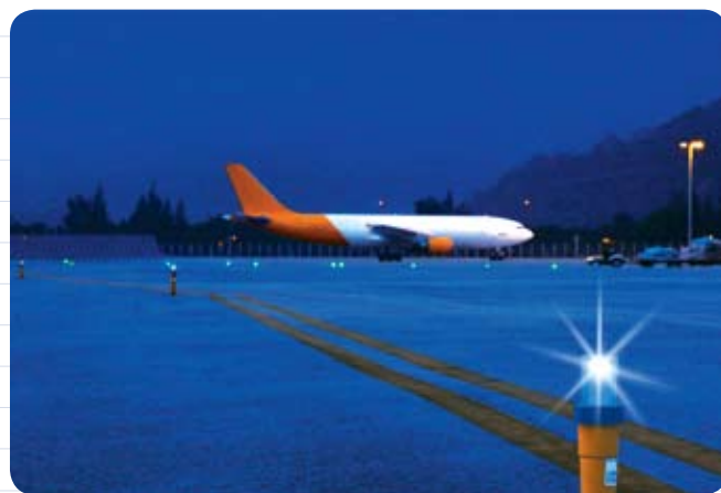
我們為香港國際機場維修保養飛行區地面燈號系統。 We maintain the Airfield Ground Lighting System at the Hong Kong International Airport.
